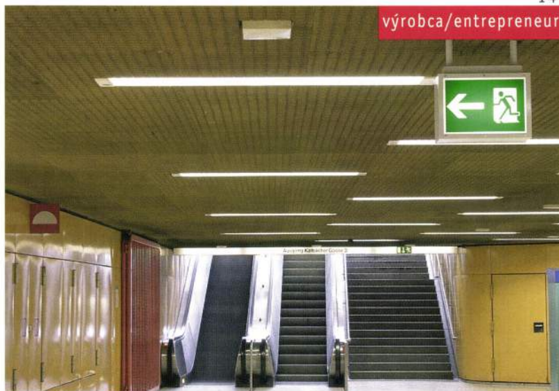
Aplikácia núdzového svietidla v metre
