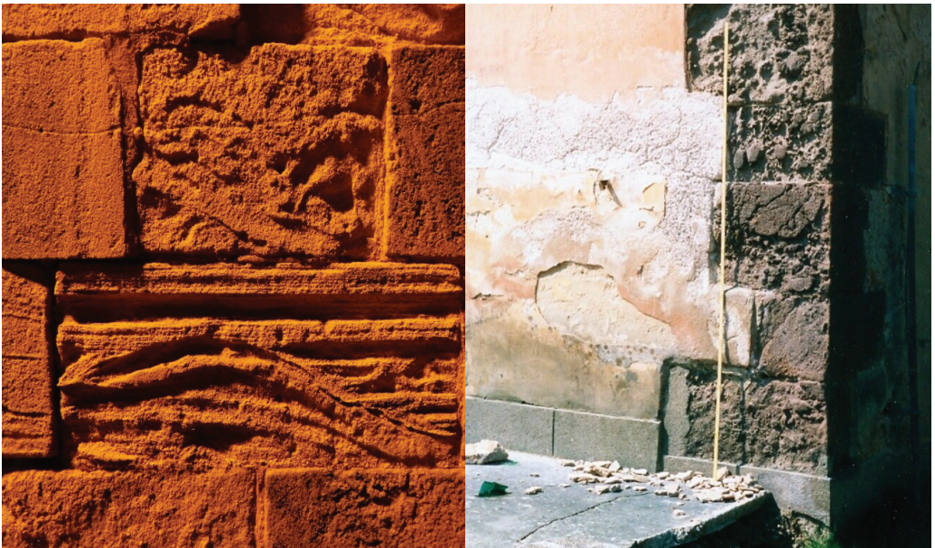
Obrázok 40 Prejavy pôsobenia a) kyslého dažďa na pieskovec (Palma de Mallorca) a b) dôsledky zasoľovania na omietke i stavebnom kamení (hradná veža v Banskej Bystrici). Foto: Andráš, 2017, 1988
