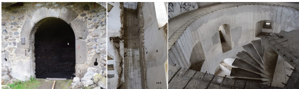
Obrázok 37 Negatívne pôsobiace adaptačné prvky: a) nesprávne rekonštruované detaily, b) invazívne osadenie inžinierskych sietí, c) reverzibilné komunikačné prvky
